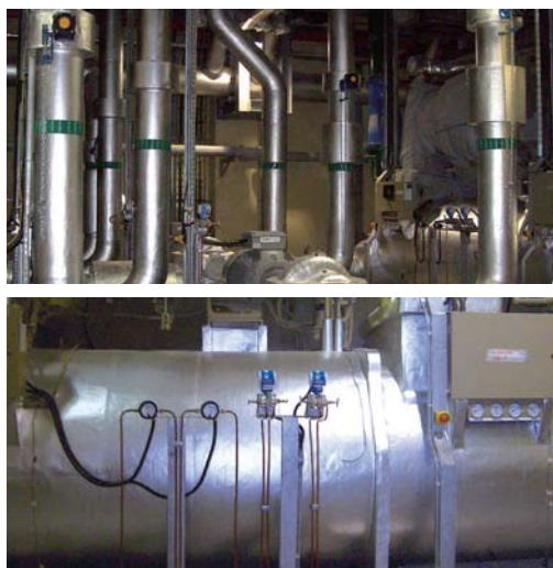
▲プラント系配管 (13層タイプ使用)
